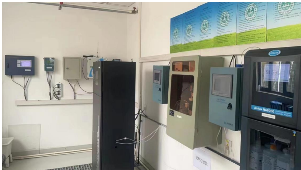
图 2-14 DQ 厂区污水处理中心在线监测设备
