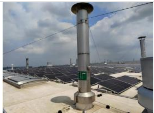
热处理燃烧尾气排气筒 P310-12
