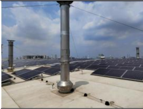
热处理燃烧尾气排气筒 P310-15
