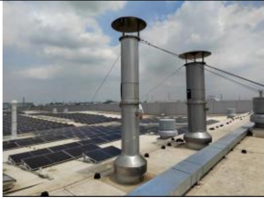
热处理燃烧尾气排气筒 P310-13
