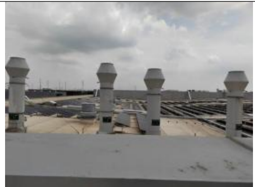
浸渍烘干废气排气筒 P310-23-26
