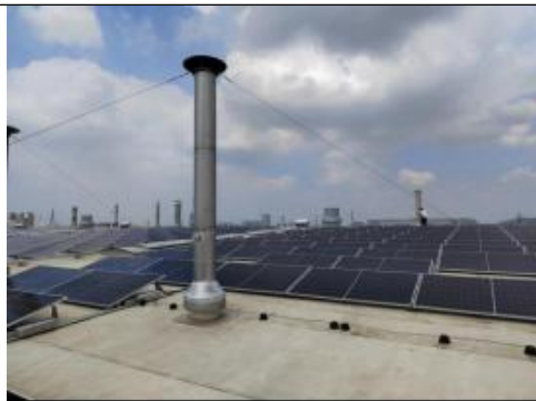
热处理燃烧尾气排气筒 P310-17
