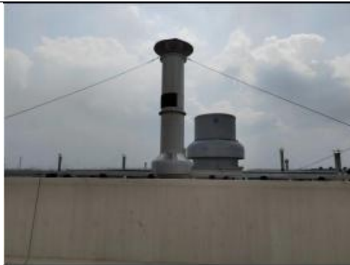
气体发生器燃气废气排气筒 P310-19
