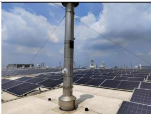
热处理燃烧尾气排气筒 P310-11
