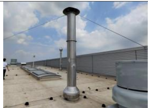
热处理燃烧尾气排气筒 P310-18
