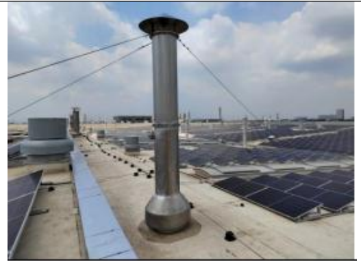
热处理燃烧尾气排气筒 P310-16
