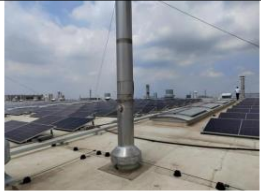
热处理燃烧尾气排气筒 P310-14
