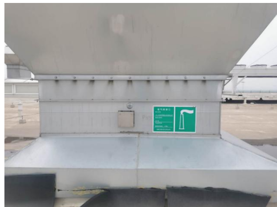
DA109 排气筒标识牌
