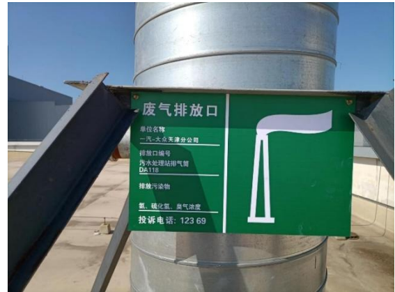
P58 排气筒标识牌
