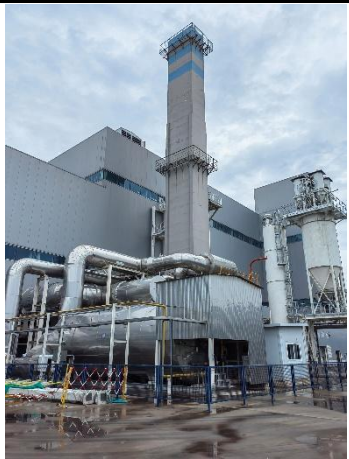
沸石转轮吸附浓缩+直接燃烧装置+DA043、 DA110 排气筒
