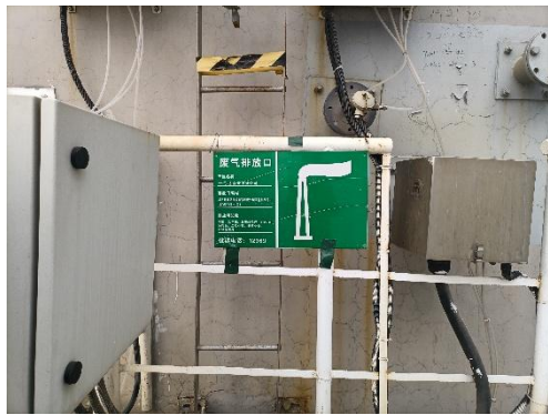
DA043 排气筒标识牌
