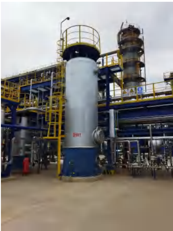
膜压机入口缓冲罐
