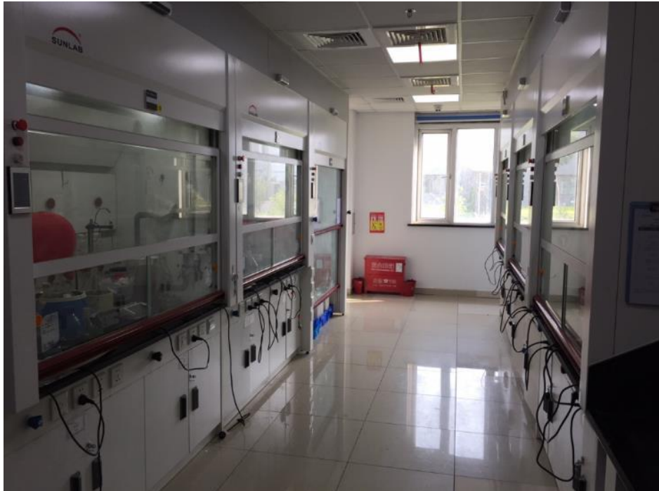
图2-5 本项目拟建设的通风柜照片（此为南海路厂区照片）
