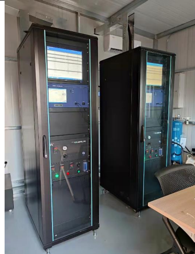
DA029、DA024 在线监测设施
