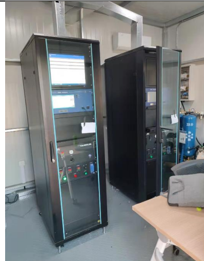
DA007、DA006 在线监测设施
