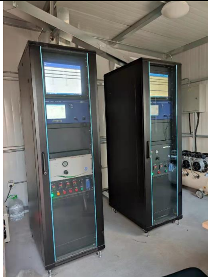
DA037、DA038 在线监测设施
