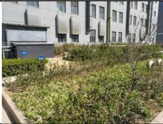
南海路厂区地埋式污水处理站
