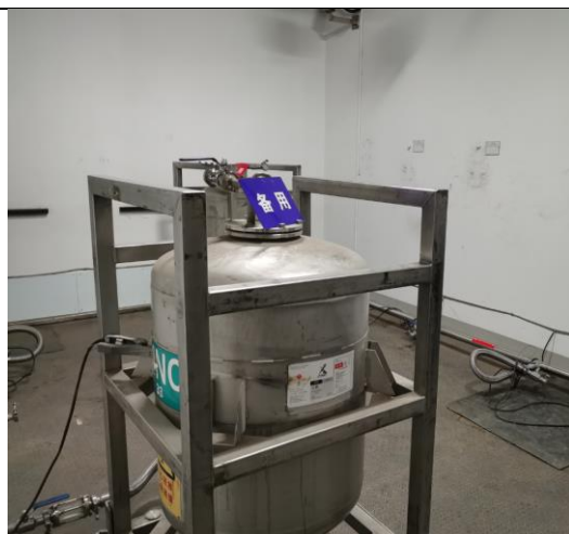
4层溶剂间乙腈罐
