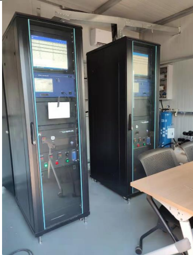
DA004、DA011 在线监测设施
