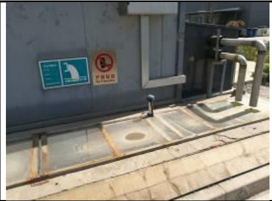
厂区污水总排放口
