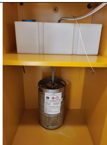
本项目实验室拟增加防火溶剂柜及乙腈桶
