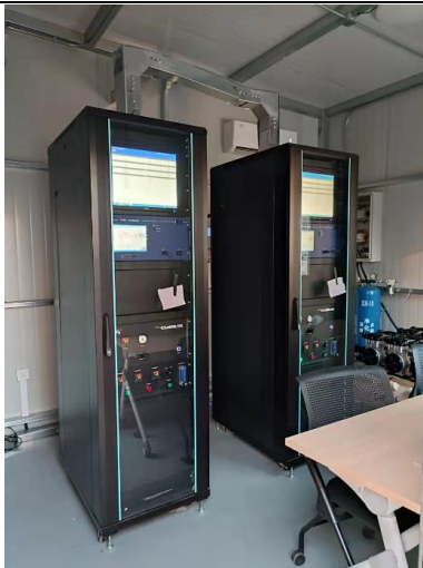
DA019、DA017 废气在线监测设备
