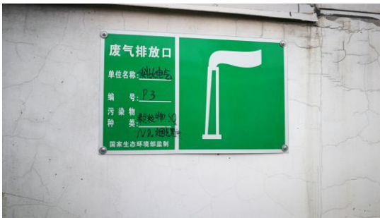
排气筒 P3 标识牌
