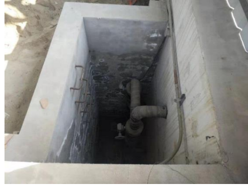
储罐与事故水池相连
