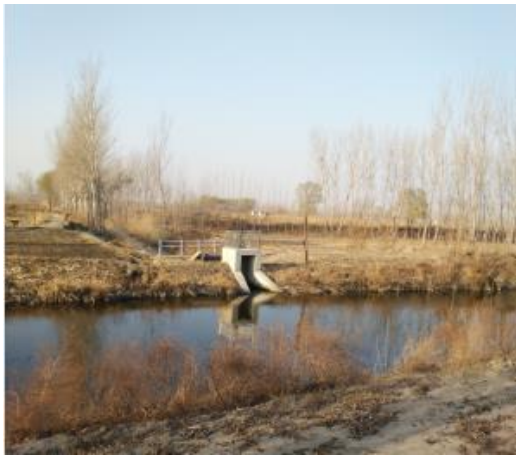
于家庄支渠 2#节制闸
