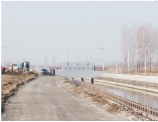
年辛庄过路涵闸
