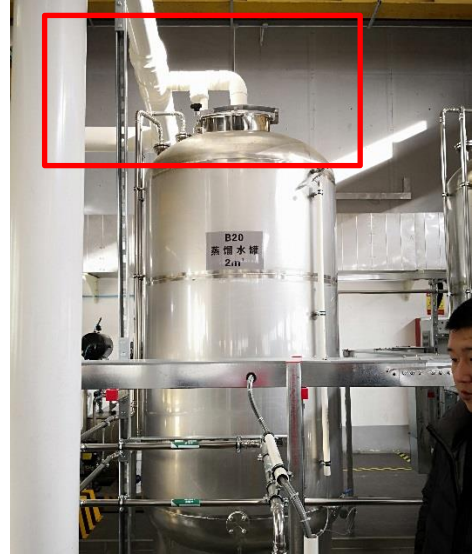
蒸馏水罐及废气收集管路
