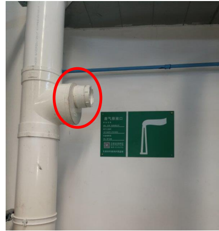
废气排放口监测口及规范化标识
