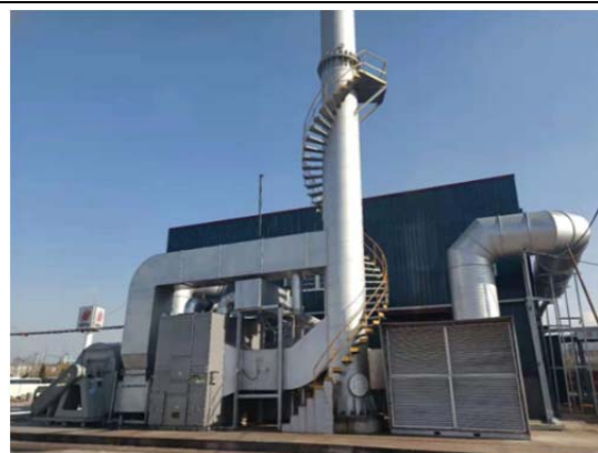
有机废气治理设施
