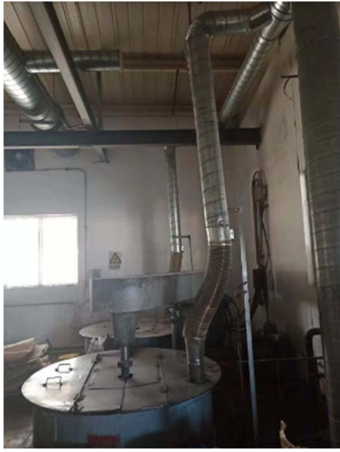
配料工序废气收集
